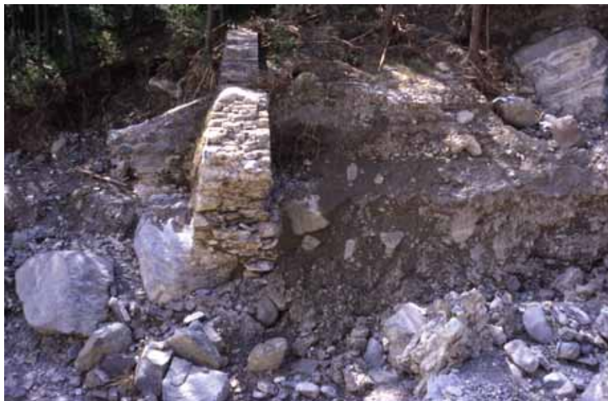
Fot. 3. Presa rota en el tramo final del barranco de Arás y resto de los sedimentos acumulados aguas arriba.
